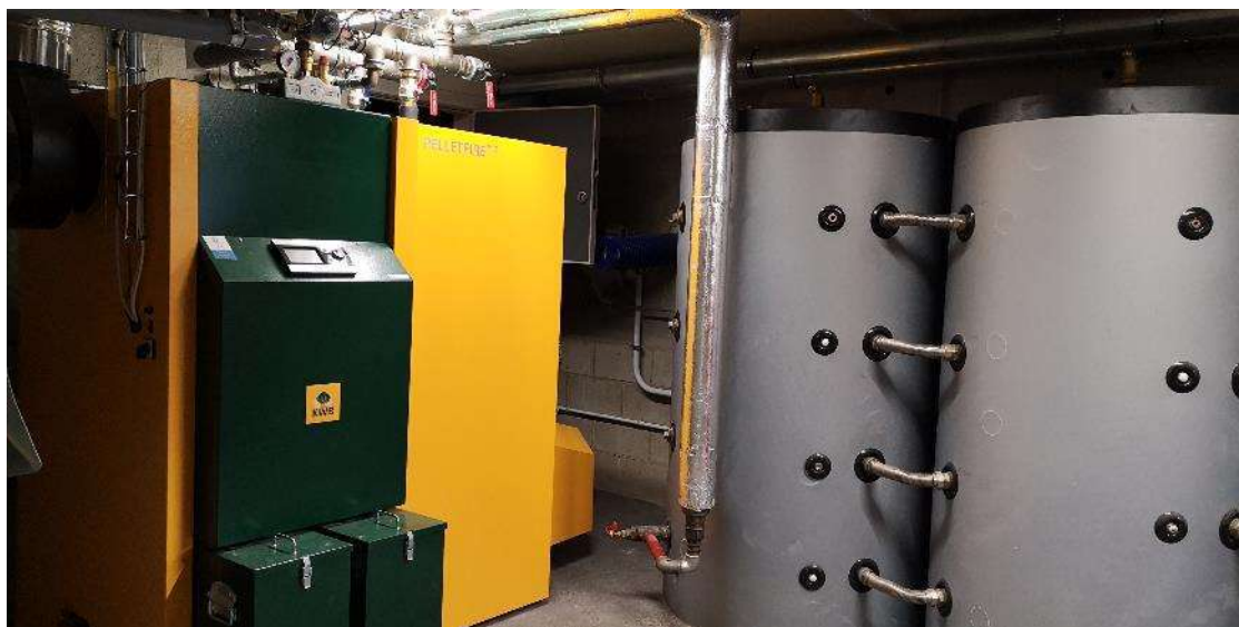
La chaudière pellets de 75 kW et ses ballons accumulateurs centralisés
